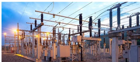
ENEA Operator. Przebudowa stacji 110/15 kV na terenie OD Szczecin. Wartość 23 mln PLN
