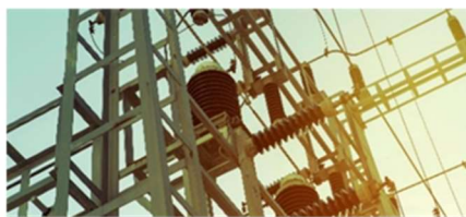
Tauron Dystrybucja. Modernizacja stacji elektroenergetycznej 110/20 kV Marciszów. Wartość 25 mln PLN
