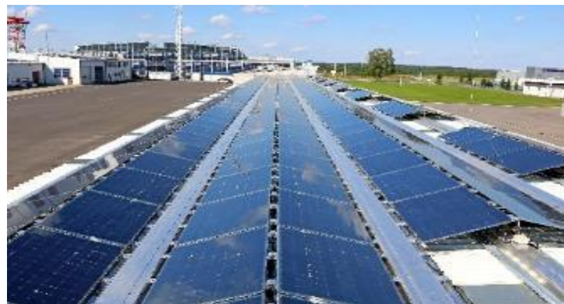
Fot 17 Instalacja PV na dachu przedsiębiorstwa
