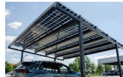
Fot 12 Fotowoltaiczny carport
