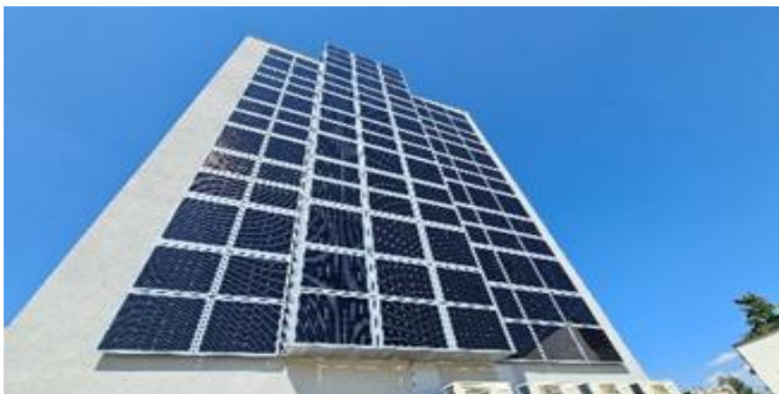
Fot 16 Instalacja PV na fasadzie budynku
